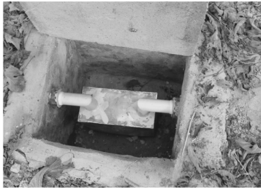
图6 沼气输气管道及凝水器
